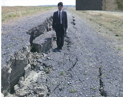
液状化対策をしていない部分
