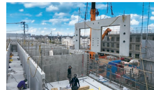
寮室棟のPC部材組立て先行は、共用棟躯体工事に伴う近隣への騒音、振動、粉塵の削減策にも
