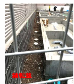
● 宅内配管事例
